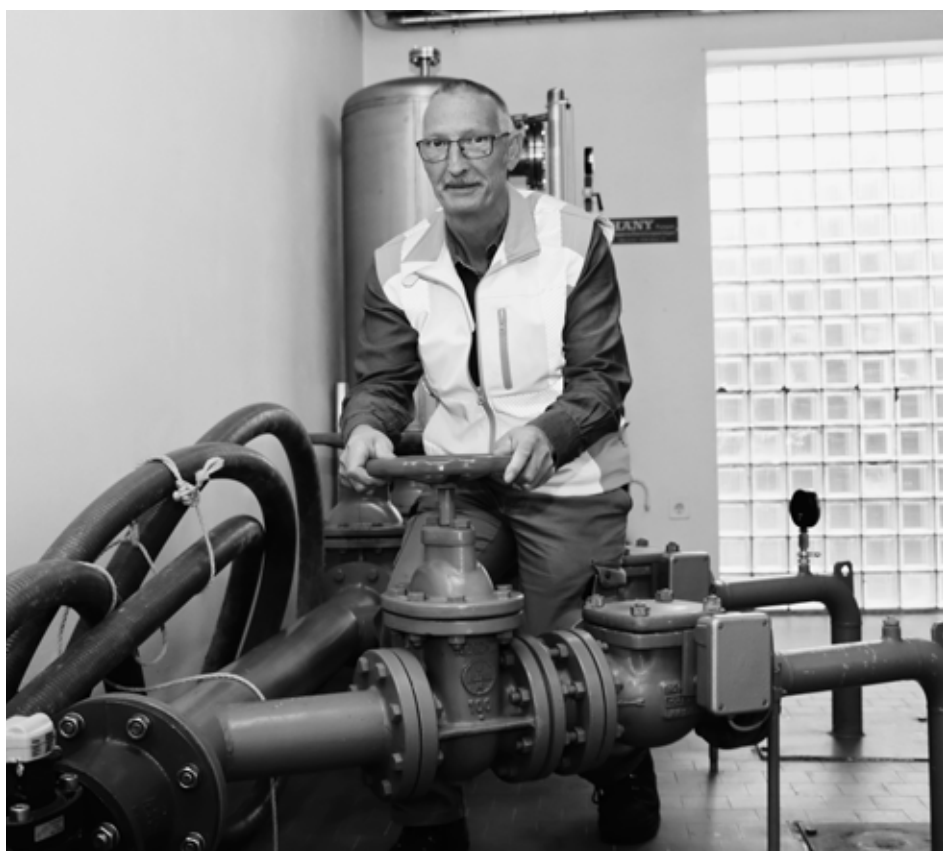
Albert Zimmermann im Grundwasser-Pumpwerk Hermoos.
